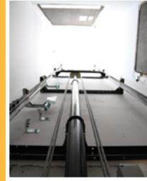
Rails d'ascenseur sur mur de bois avec finition Gypse
