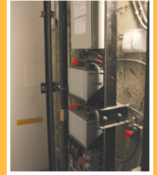
Mécanique 24V à l'intérieur de la cage d'ascenseur
