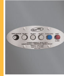
Station de commande dans la cabine
